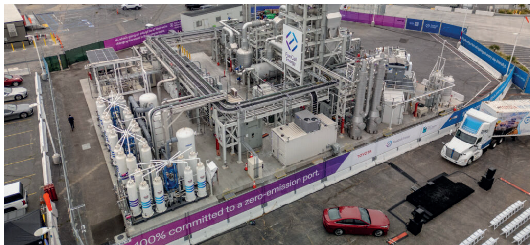
Instalaciones de Toyota y FuelCell Energy TriGen en el Puerto de Long Beach 71 . Foto: Cortesía del Puerto de Long Beach.
